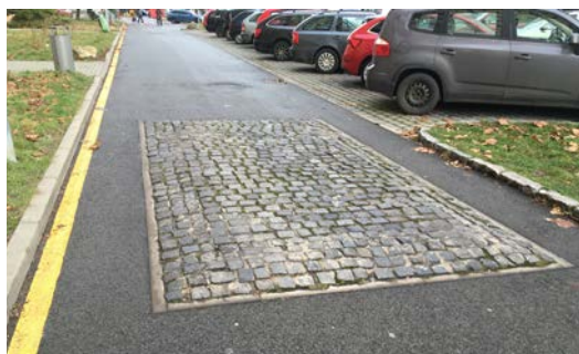
Stavební zpomalovací polštář
